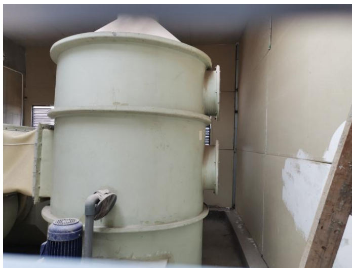
图 4.6 玻璃钢酸雾净化塔废气处理设施
