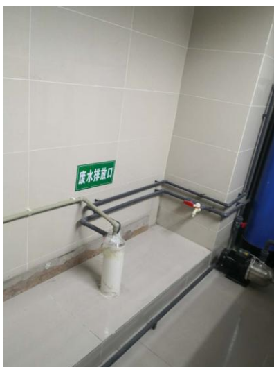
废水排放口标识
