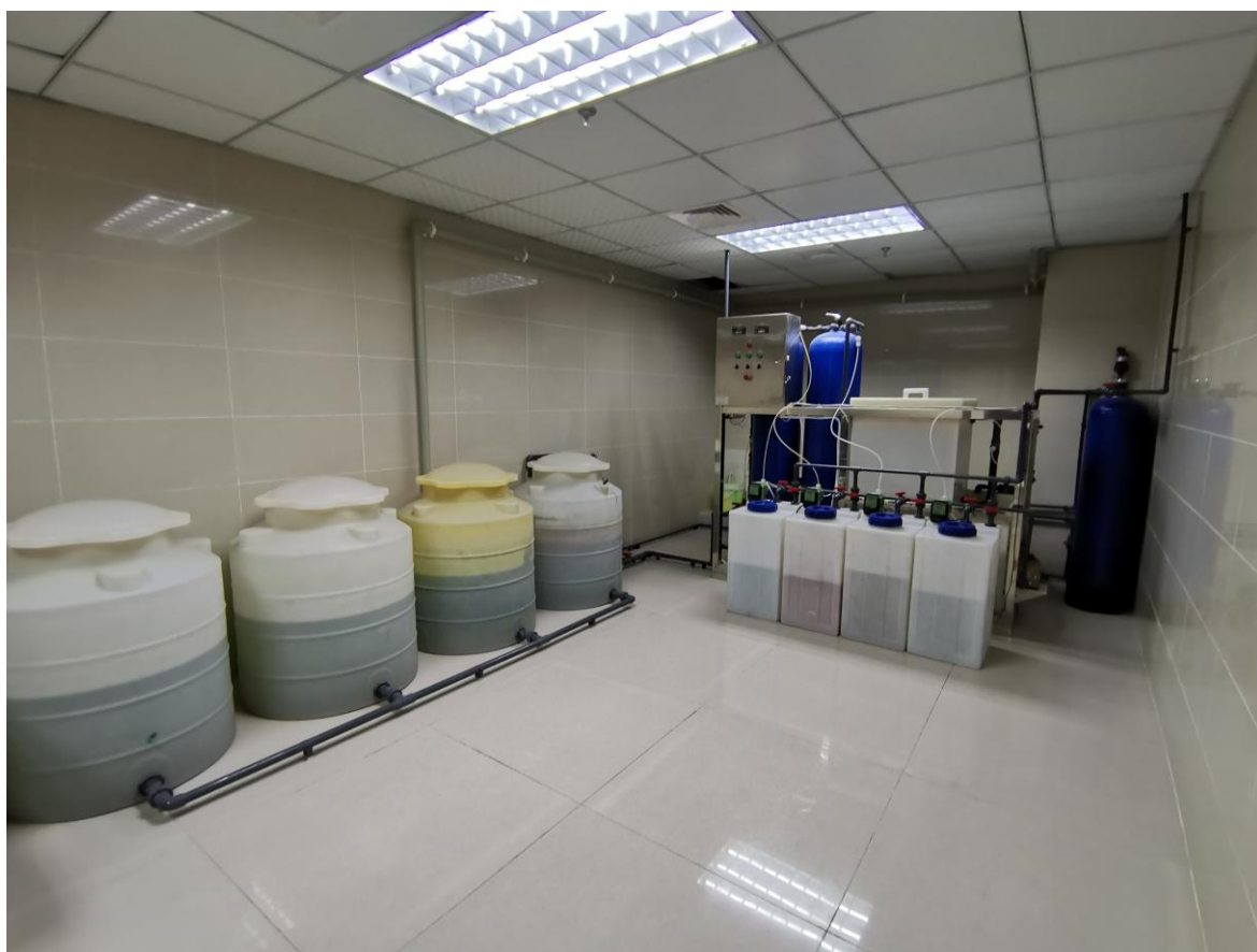
图 4.1 实验室废水处理设施
